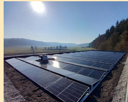
Wasserwerk Aitrachtal アイトラッハ タールの上水 供給設備 2022
