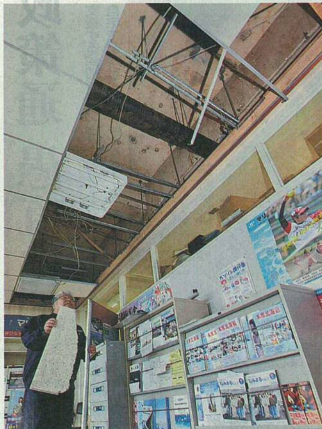
函館市南茅部地区では建物の天井が落下するなどの被害が出た。16日午後3時35分、函館市白尻町、南かやべ漁協本所
